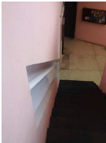
Rampe-éclairage dans un escalier Source : Célia Houdart
